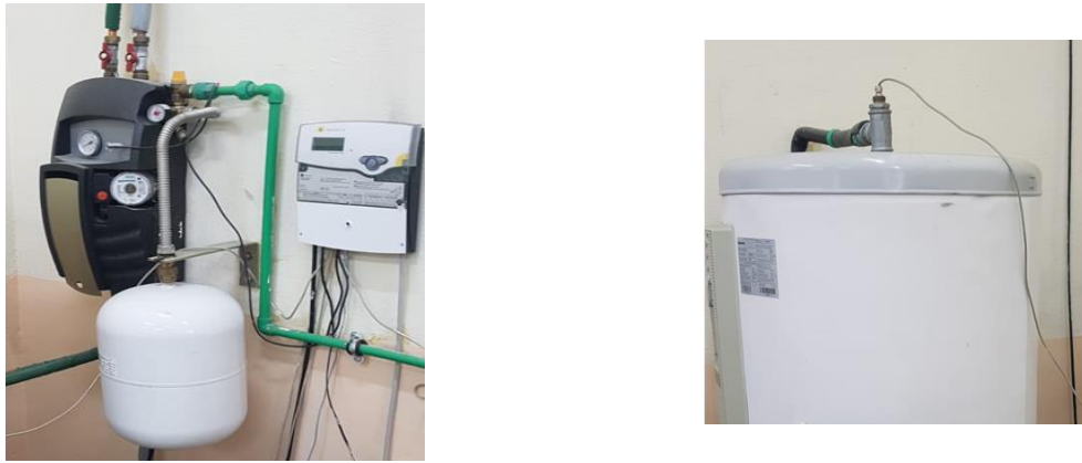
Figura 6-12: Pompa qarkulluese, ena e zgjerimit dhe akumul termik
